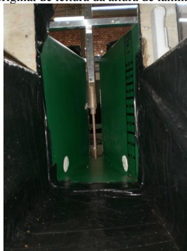
Figura 5 – Foto da escala original de leitura da altura de lâmina de água na Calha Parshall
