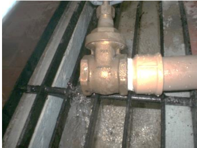
Figura 9 – Foto do extremo final do sifão invertido utilizado no refinamento do procedimento
